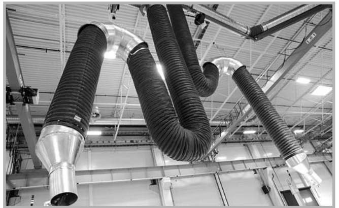
Фото 1. Система откачивания выхлопных газов.
